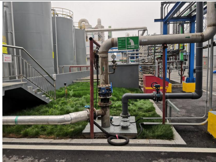
4.1-13 污水排放口可控阀门及标示牌
