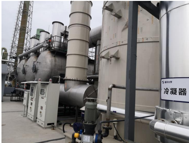
冷冻+稀酸吸收+碱、次氯酸钠混合液吸收+除雾+活性炭吸附/脱附/ (9#) 排气筒
