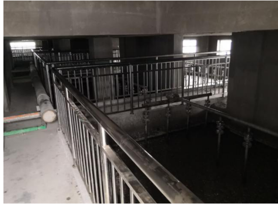
污水站生化池
